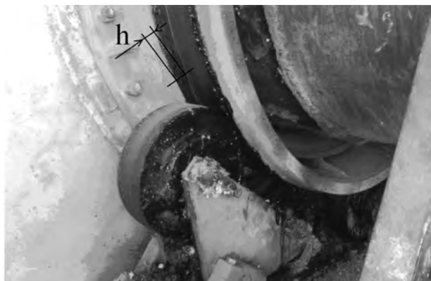
Рис. 4. Износ цапфы барабана 2СБ-10. h – глубина износа цапфы
