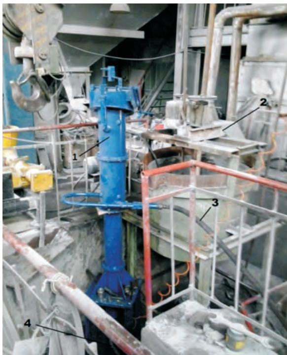
Рисунок 1 – Установка для флотации золошлаковых отходов:
